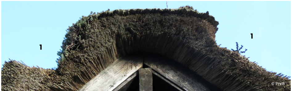
Hauts de rive abîmés : érosion du roseau (1)
