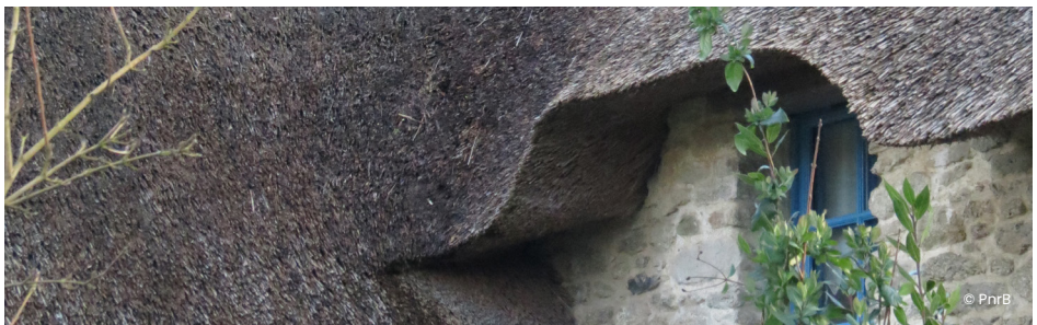
Les noues s'abîment plus vite : elles séchent moins vite car drainent plus d'eau et ce d'autant plus sous l'ombre d'une lucarne
