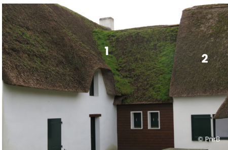
Les mousses mettent en évidence des zones plus sensibles comme les noues (1). Le roseau s'érode davantage sous le faîtage (2).
