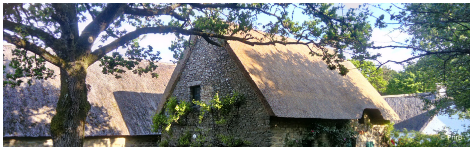
Les branches surplombent le toit, ce qui favorise le développement de mousses et le dépôt de débris végétaux.
