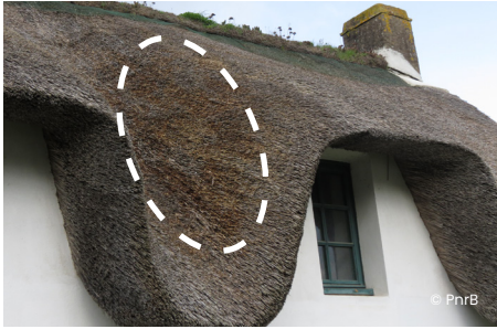
Tâches orangées au niveau de la noue de lucarne
